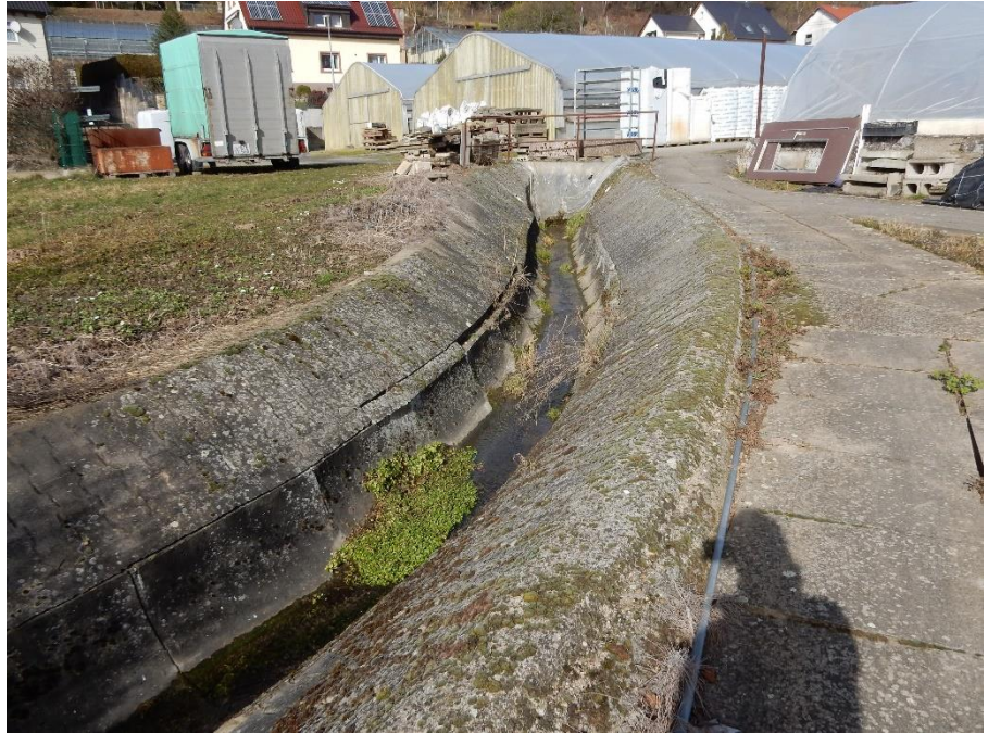
Foto 4: Das durch das Untersu- chungsgebiet fließende Tairnbächle ist teilweise verdolt und mit Sohl- und Uferbefestigung massiv verbaut.
